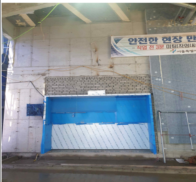
지하 기계식 주차장 출입구
