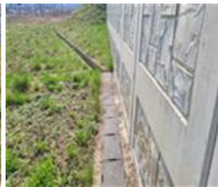
< 사면입구 폐쇄형 배수로 >
