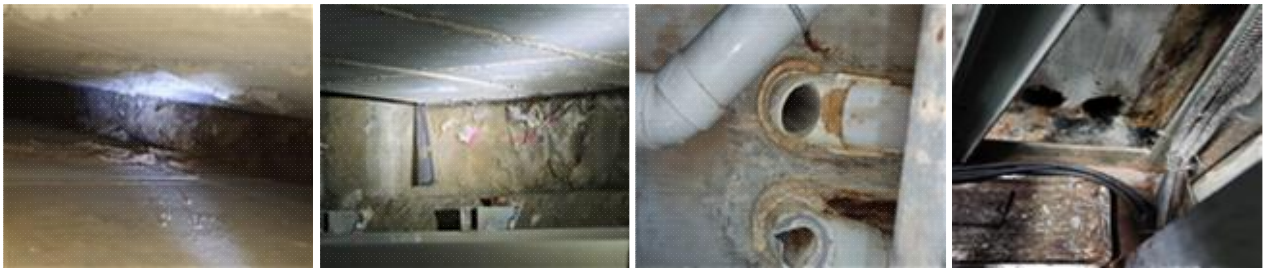
<배수로 슬러지 막힘> <배수로 쓰레기 막힘> <배수관 슬러지 막힘> <승강기 피트 막힘>
