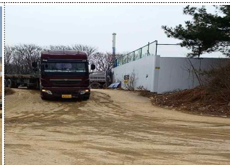
공사 출입차량 세륜시설 미설치
