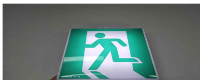
< 피난유도등 추가 설치 >
