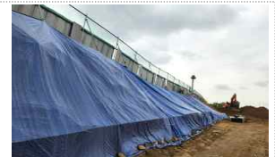
공사장 점검·조치 예시 (굴토 사면 관리 불량 → 방수포 보호)
