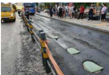
〈아스팔트 포장 파손〉
