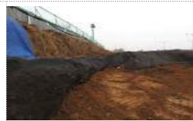
공사장 점검·조치 예시 (굴토 사면 관리 불량 → 방수포 보호)
