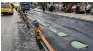
<아스팔트 포장 파손>
