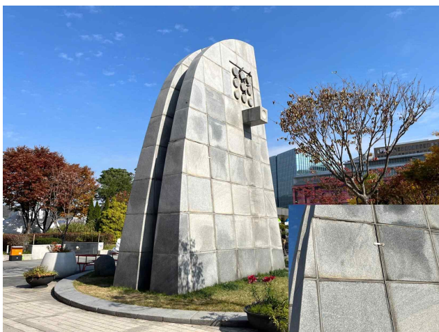
정보통신발상지 기념탑(약20mm 균열 발생)
