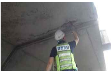
〈교량 콘크리트 박락 위험부〉
