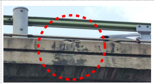
〈망원2교 슬래브 박락〉
