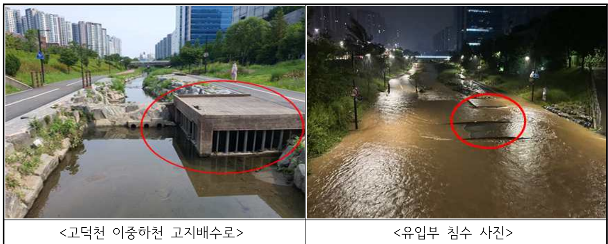
[표] 고덕천 이중하천 고지배수로 현황 및 침수사진
