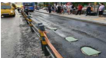
<아스팔트 포장 파손>
