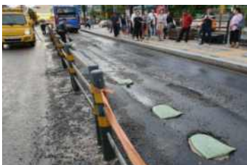
<아스팔트 포장 파손>
