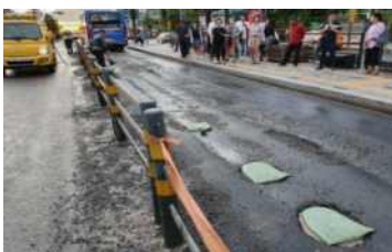
〈아스팔트 포장 파손〉
