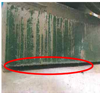
[송수펌프동 하부 균열]
