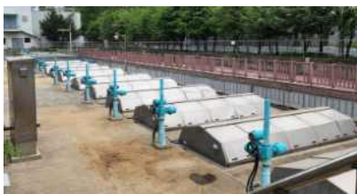
<탄천1처리장 여과시설 개선>
