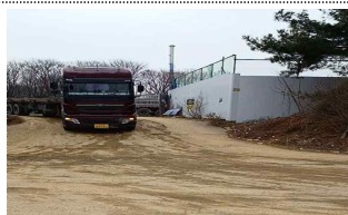
공사차량 세륜시설 미설치
