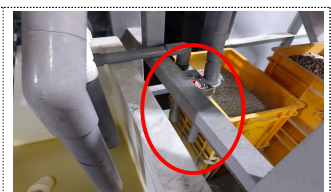
폐수 무단배출(가지배관 설치)
