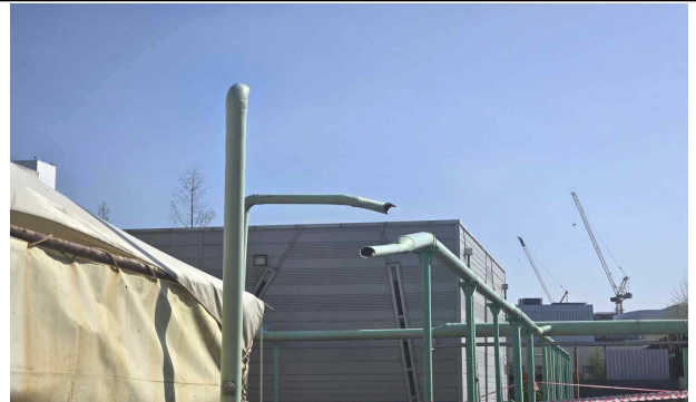
악취탈취 가지배관(약 10m) 파손
