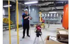
< 건축물 부동침하 점검 >
