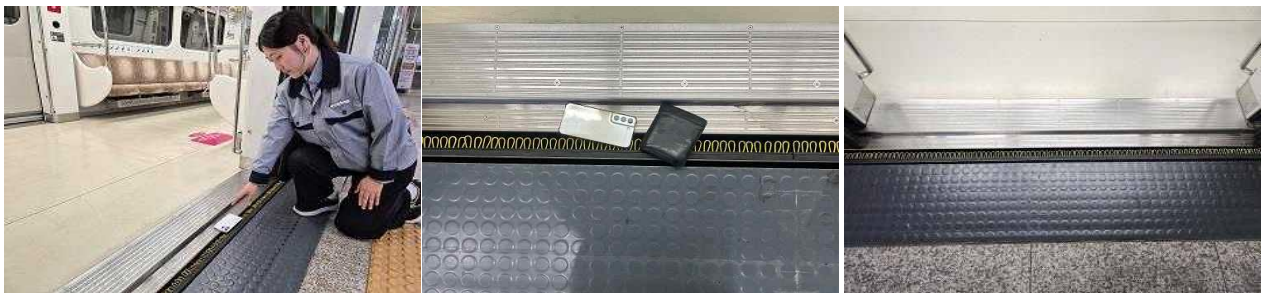
<유실물 방지망 설치 사례>
