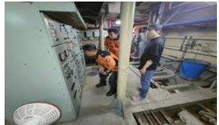
〈 지하 기계실 펌프 점검 〉
