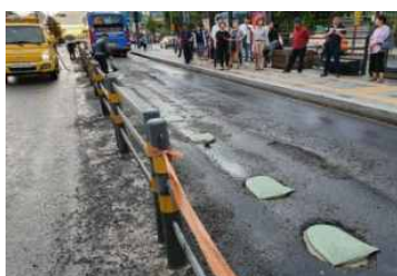
(기존) 아스팔트포장 파손
