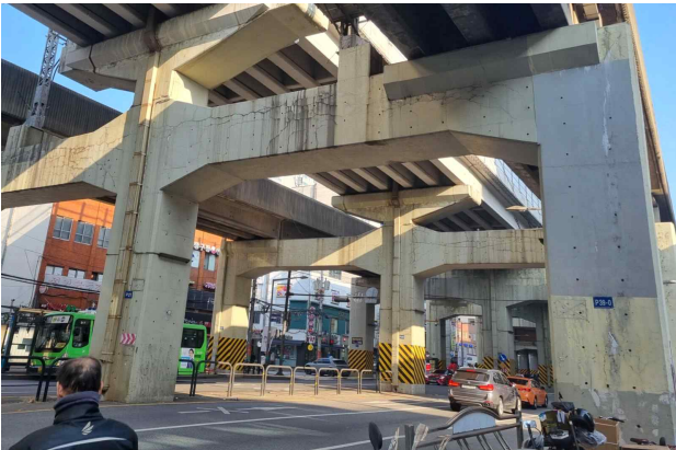
< 탄산화 보수 전 >
