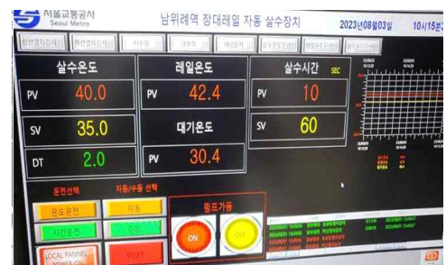
< 자동 살수장치 모니터링 >
