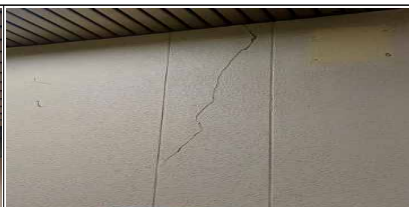
벽면 균열에 따른 누수
