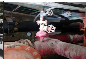
지하구 노후 배관 정비대상
