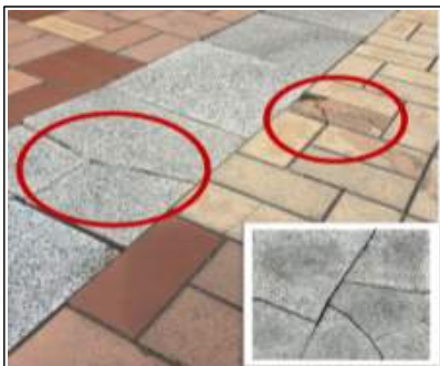
보도블럭 파손 및 침하
