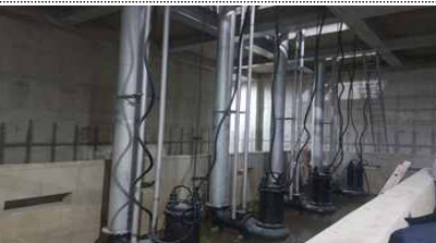
신림공영차고지 저류조 (펌프시설)
