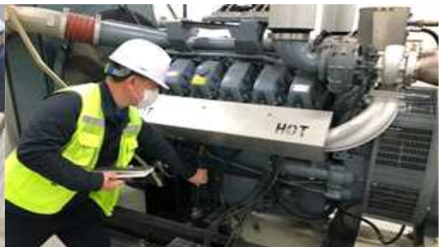
〈송파구 위례중양지하차도 비상발전기 점검〉
