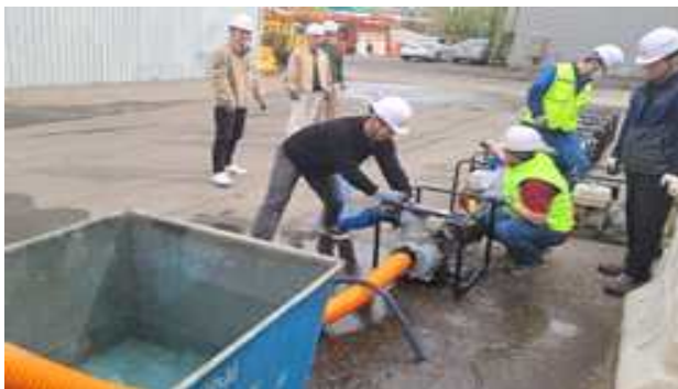
〈배수펌프 가동상태 점검〉
