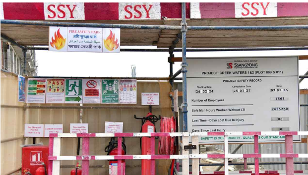
③ 쌍용건설 두바이 Creek Waters 프로젝트 소방시설
