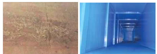
<기존 구조물 콘크리트 열화>
